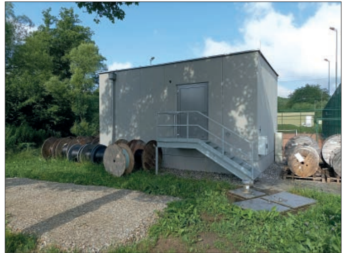
Die Schaltzentrale (POP) im Freizeitzentrum St. Marein, für genügend Kapazitäten im weiteren Ausbaubereich
