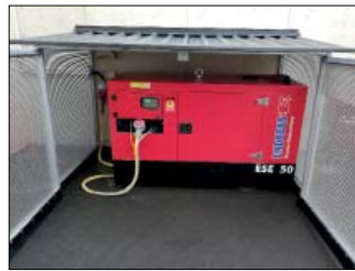
Notstromversorgung im Feuerwehrhaus Krumegg
